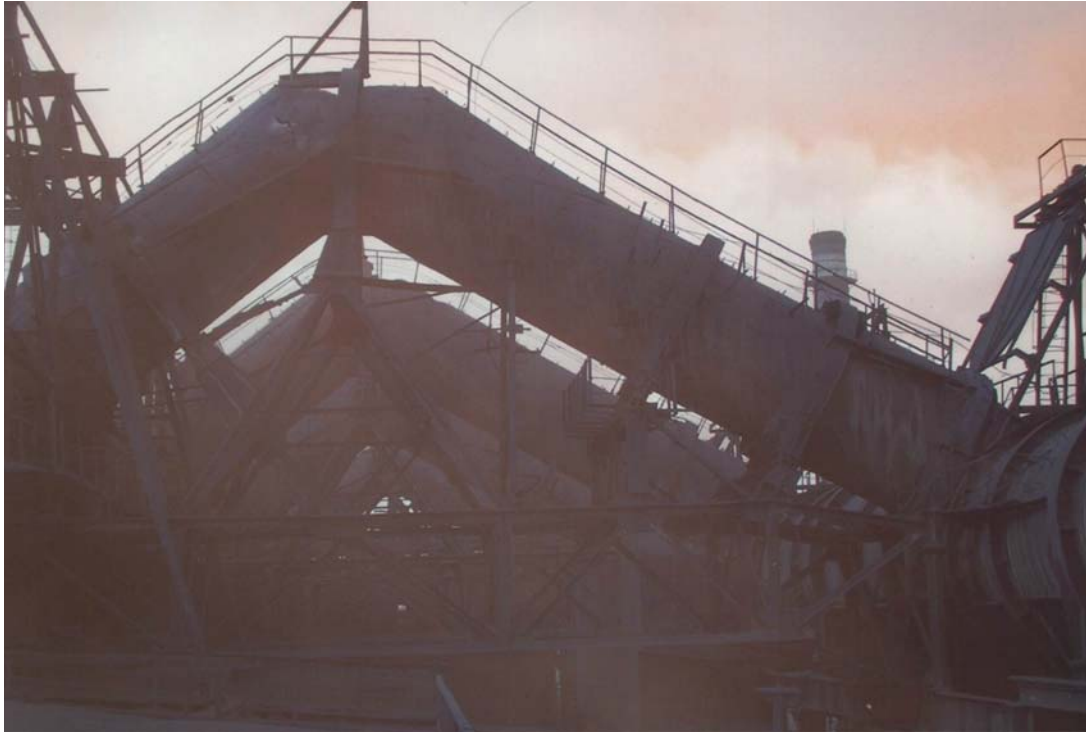
Рисунок 8. Газоходы шахтных печей Южно-Уральского Никелевого комбината.
