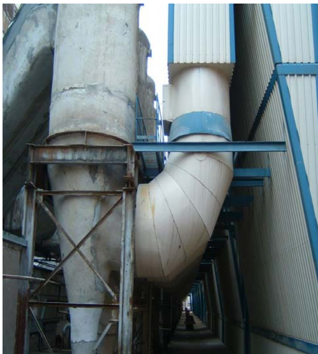
Рисунок 6. Газоход Нарвской ГРЭС.
